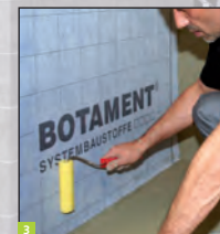
3 Wariant 2: Przyklej matę uszczelniająco-kompensującą BOTAMENT® AE za pomocą zaprawy klejowej BOTAMENT® M 10 Speed lub M 21, a następnie docisnąć wałkiem, aby usunąć nierówności. W narożnikach wewnętrznych zamontować systemową taśmę uszczelniającą BOTAMENT® SB 78.
